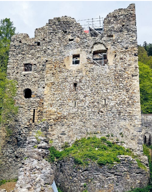
Diese Ansicht der Westfassaden vom Süd- und Nordannex zeigt die desolaten Mauerkronen im Bestand und der nur noch als ausgebrochene und geschwächte Brücke erkennbare Fenstersturz am Südannex. Wäre diese Brücke ausgebrochen und abgestürzt, wäre die ganze Süd-West-Ecke des Südannex instabil geworden.
