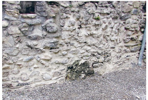
Mauer in deren Sockelzone verschiedene Fehlstellen zum Vorschein (links), welche tragend unterfangen wurden.
