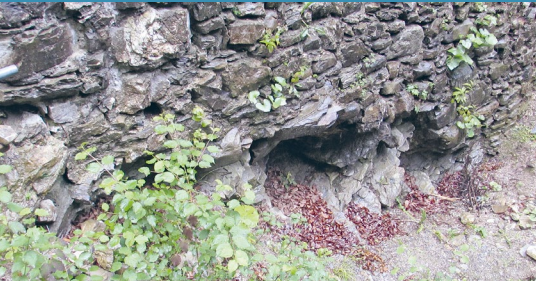
Diese mauertiefe Ausbruchstelle in der Sockelzone an der Nordwest-Fassade des jüngeren Wohnbaus musste mit mittelalterlichem Mauerwerk tragend unterfangen werden.
