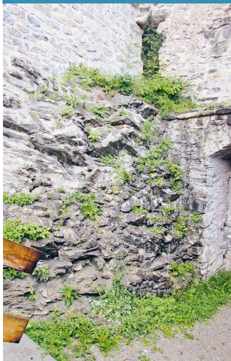
Diese aus gewachsenem Felsen und integriertem Bruchsteinmauerwerk bestehende innere Eckausbildung beim Eingang in den Torwin-
