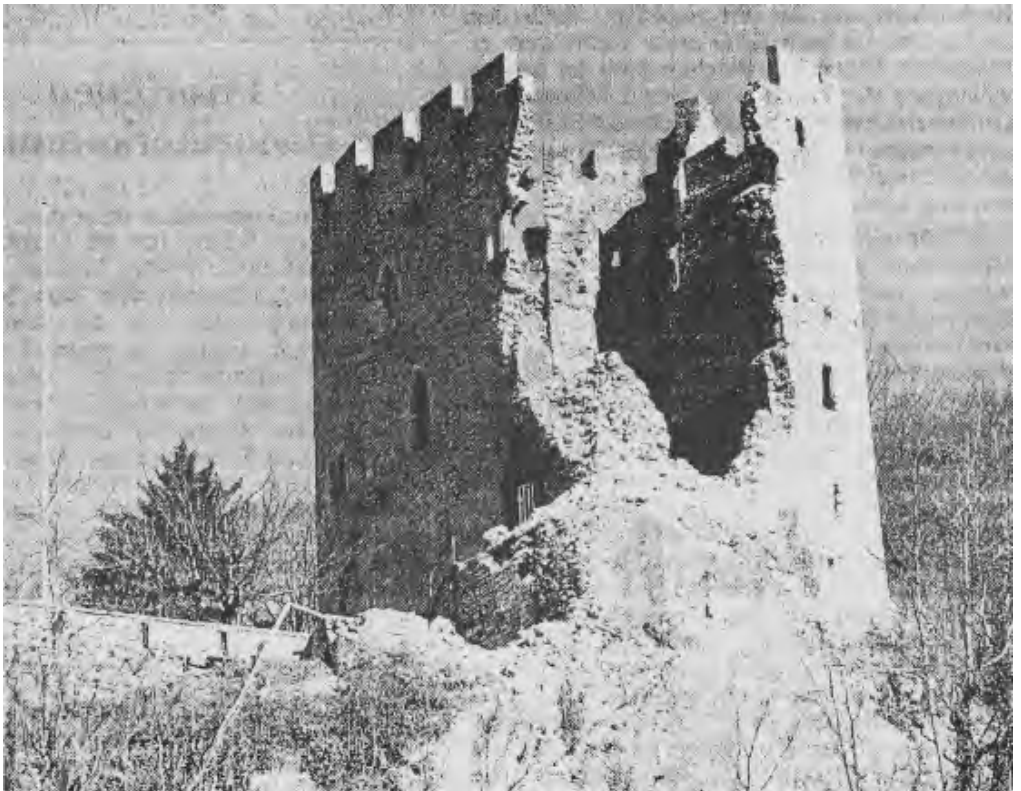
Die Südwand der Burg Neu-Thierstein in Büsserach SO ist Anfang März 1997 abgestürzt - zum Glück in der Nacht, als keine Besucher auf der Ruine weilten. Ein Wiederaufbau der stolzen Anlage wird derzeit diskutiert. (Foto key, NZZ vom 10.3.1997)
