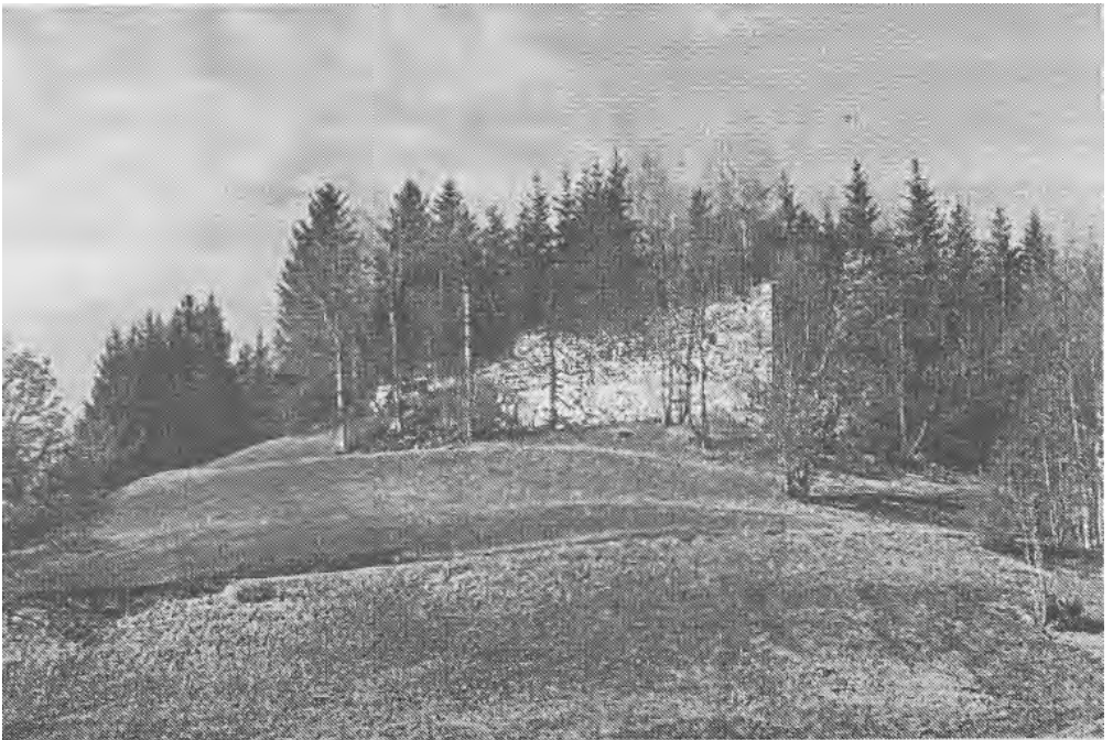
Die wenig bekannte Burg Kapfenstein bei Obersansch/Küblis. Trotz einer Sicherung vor einem Jahrzehnt hat einsickerndes Regenwasser dem Gemäuer arg zugesetzt. Eine wasserabweisende Mauerabdeckung, z. B. mit Quarzitplatten, könnte hier dauernde Abhilfe schaffen. (nach einer Foto von 1937)
