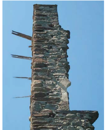
Der leicht ergänzte Hocheingang von Cagliatscha sowie Balkenreste der Wohn- und Wehrlaube (Quelle: commons.wikimedia)
