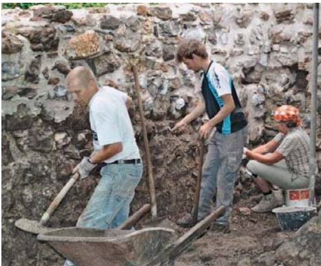
Strahlegg: Schritt für Schritt wird die gleiche Mauer auf der Innenseite gereinigt und danach wie im oberen Teil bearbeitet. An der Arbeit zu sehen sind Marcel Frei, Lucas Mosimann und Diana Walli. (Foto W. Keller)
