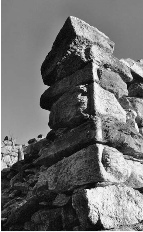
Die Westecke der Turmmauer ist in gefährlicher Auflösung. (Foto BVG)
